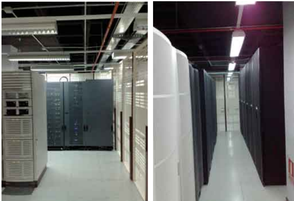
Figura 2 Equipos de catastro en el espacio habilitado (Jaula)
